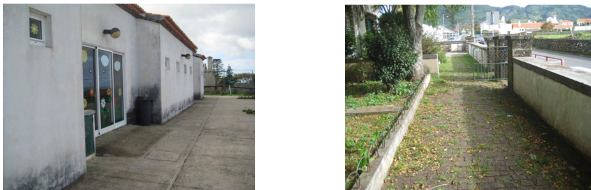
Figura 3.12_Exemplo do estado de conservação dos recintos escolares (EB1/JI Almagreira)
