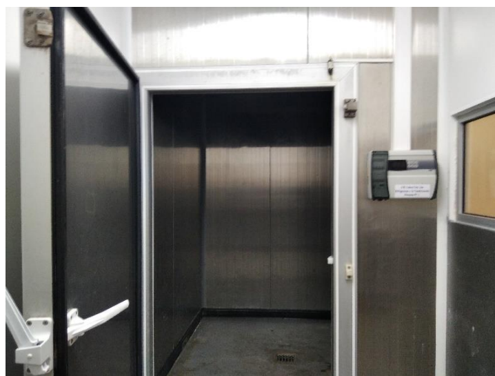
Espaço interior - Câmara Frigorífica
